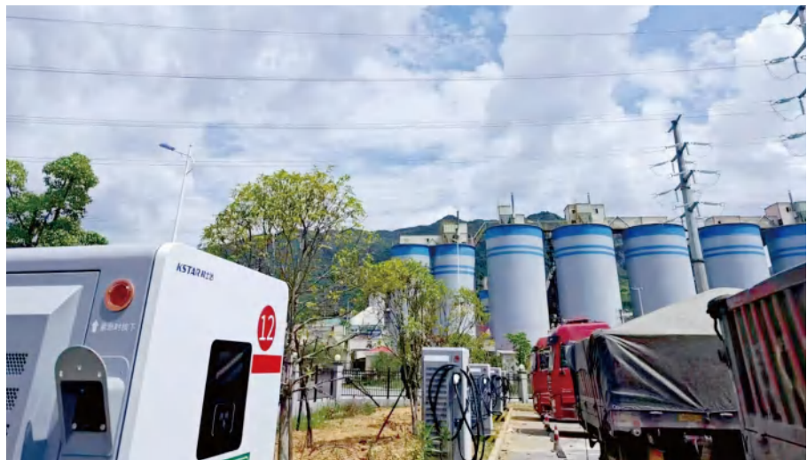
石门海螺水泥重卡补能项目
