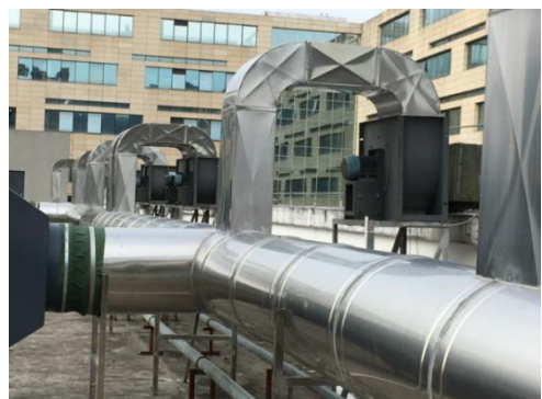
楼顶收集管道
