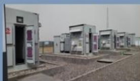
华电叶城10MW/20MWh新能源侧储能
