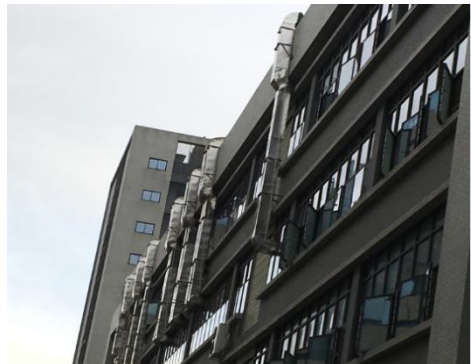
车间至楼顶收集管道
