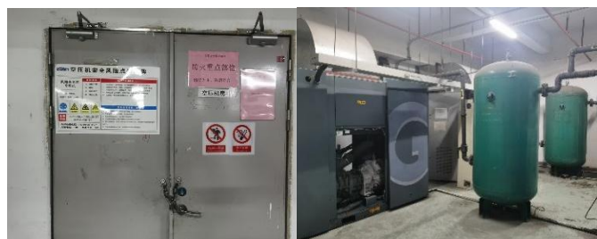
独立的空压机隔音房
