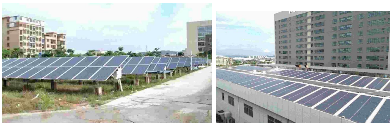
广东科士达地面的屋顶光伏项目
