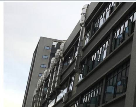
车间至楼顶收集管 道
