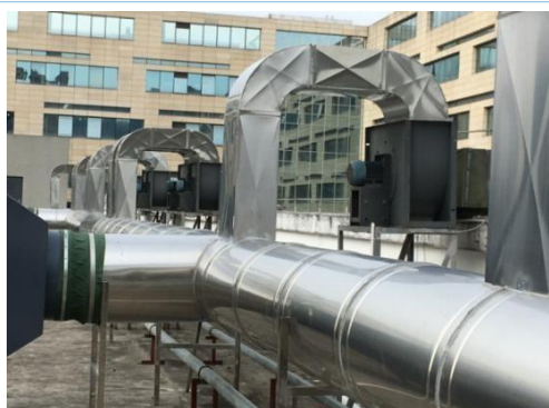
楼顶收集管 道
