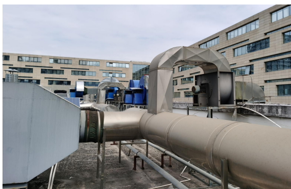
生产焊接废气通过抽风管收集
