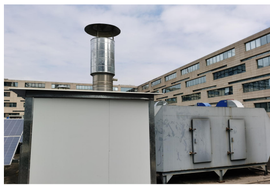
废气经过活性炭过滤达标后排放
