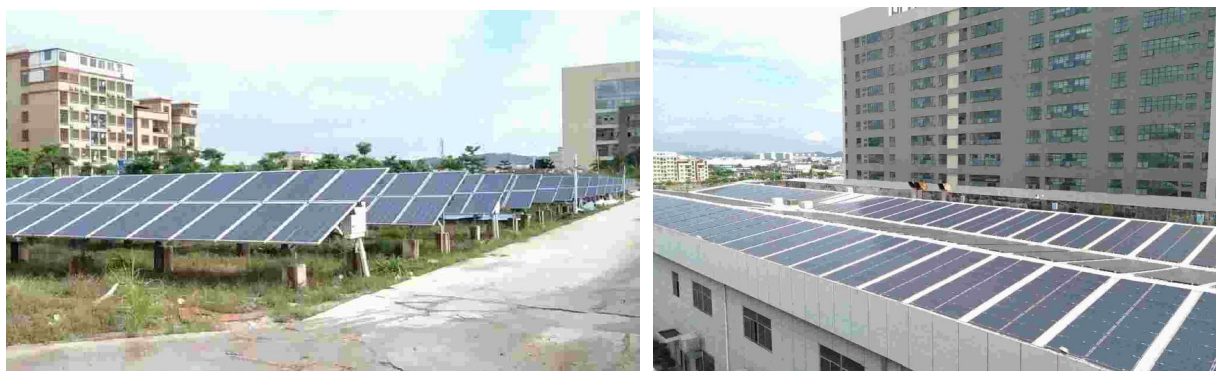
广东科士达地面的屋顶光伏项目
