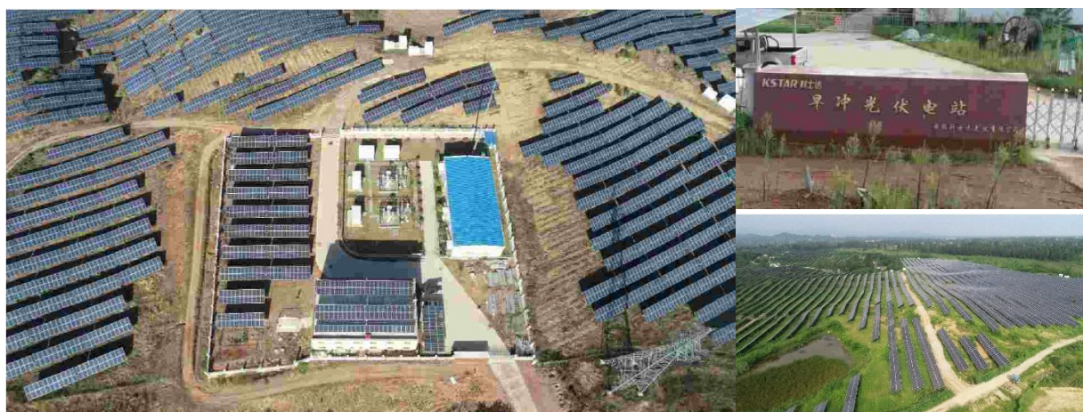
安徽科士达光伏发电项目
